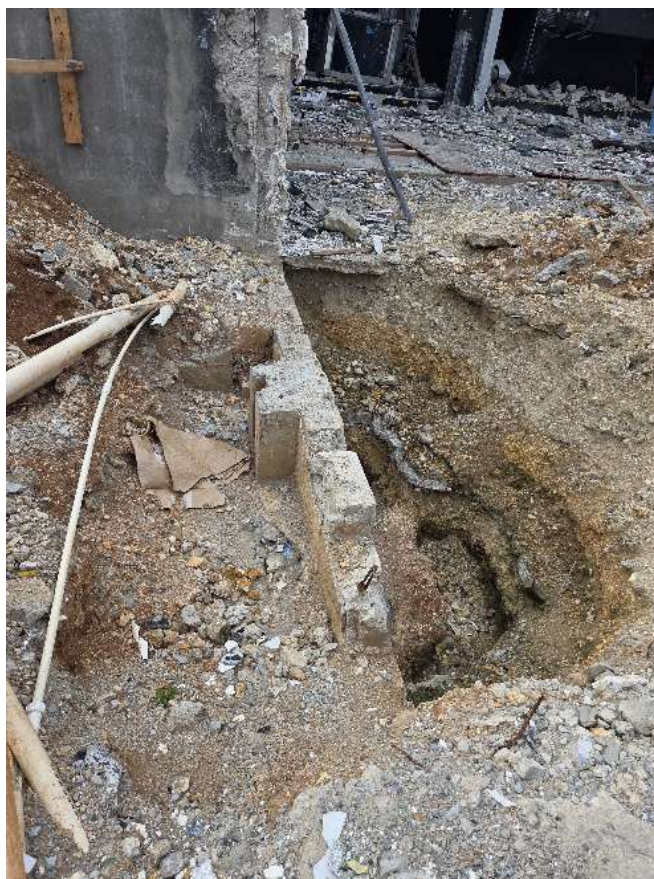
IMAGEN 29: ZAPATA DE LA COLUMNA ELIMINADA EN ESCENARIO-.
