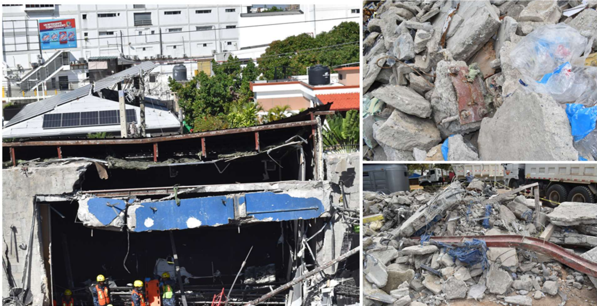
IMAGEN 21: PERFIL METÁLICO DE REFUERZO BAJO VIGA DEL ESCENARIO, NÓTESE LA PLACA DE ACERO REFERIDA
